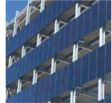
PV Anlagen auf Parkhausfassade
