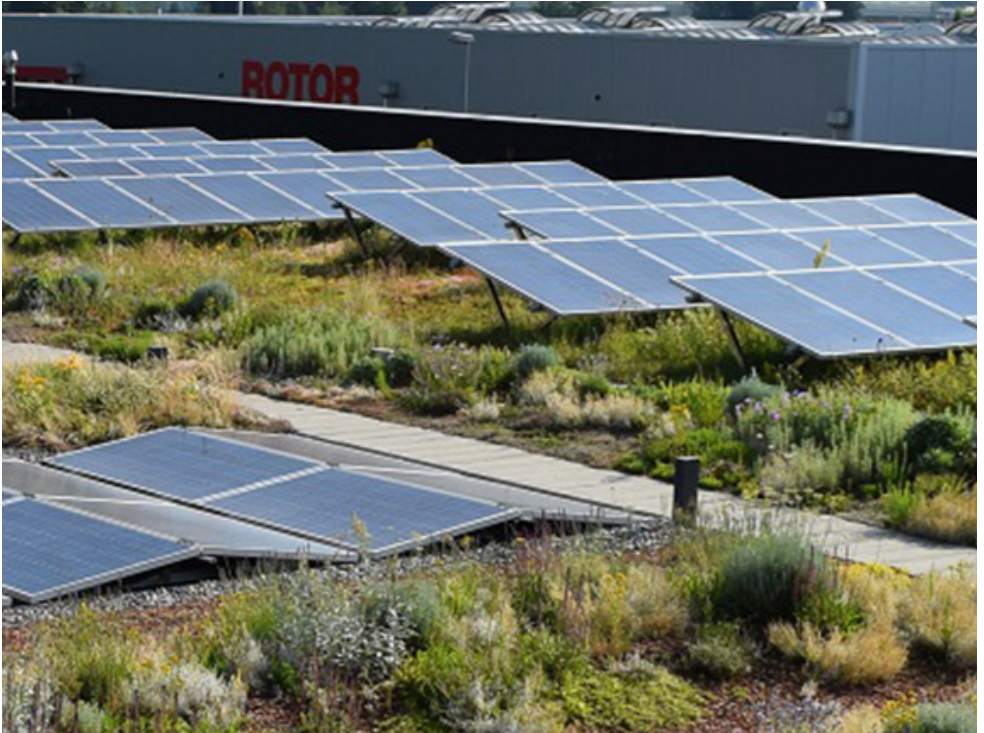
Photovoltaikanlage und grüne Dächer
