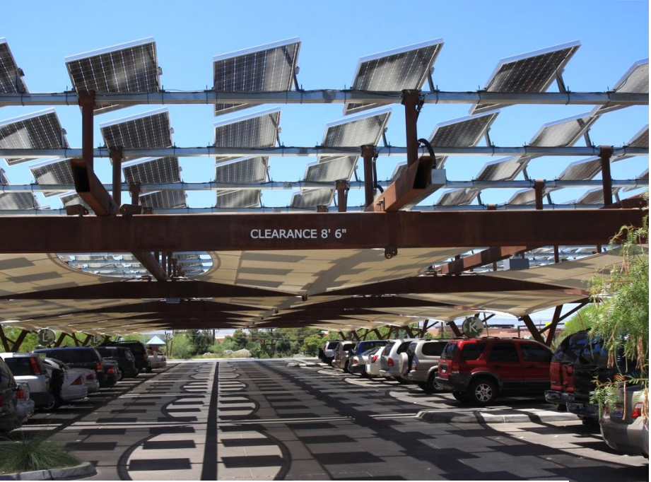
Photovoltaik Pergola für Parkhaus
