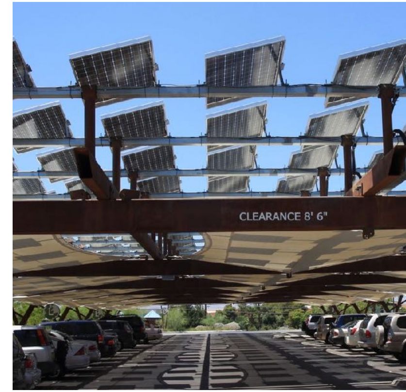
PV Pergola auf Parkdach
