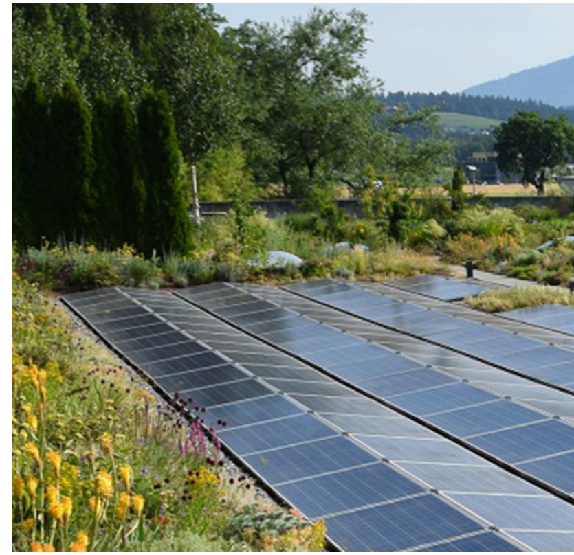
PV Anlagen auf Gründächern
