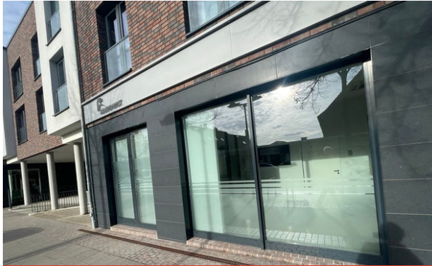
Erdgeschosslagen ohne publikumswirksame Nutzung mit unattraktiven, geschlossenen Fassaden
